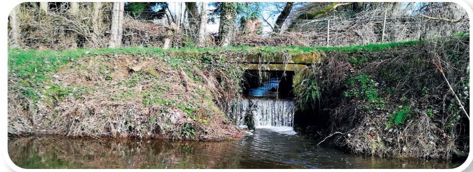
Ouvrage infranchissable par le poisson
